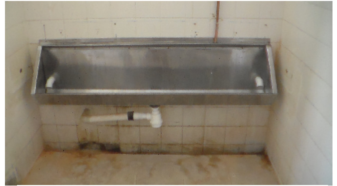
Mingitorio con descarga de aguas grises
