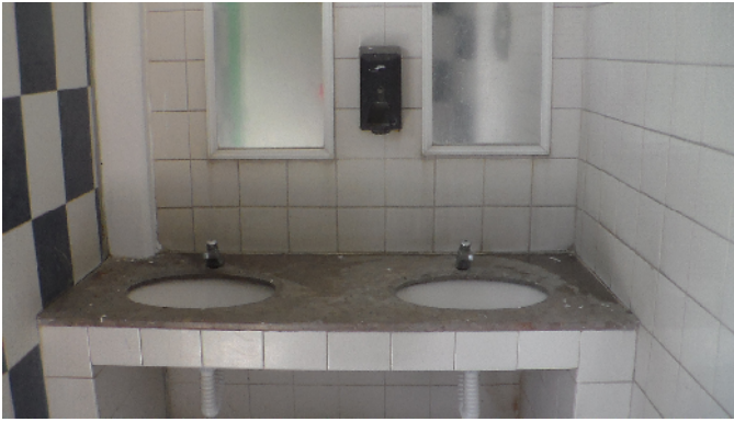
Lavabos proveedores de aguas grises a mingitorio
